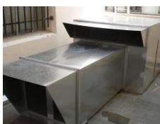
Caissons de climatiseur
